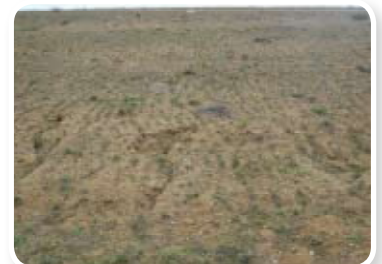
Parement aval non enherbé avec ravines
