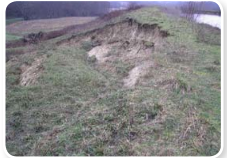
Glissement de terrain à partir de la crête
