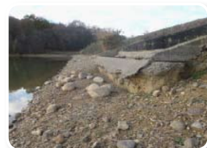
Absence d'antibatillage et érosion
