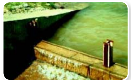
Rehausse non conforme
