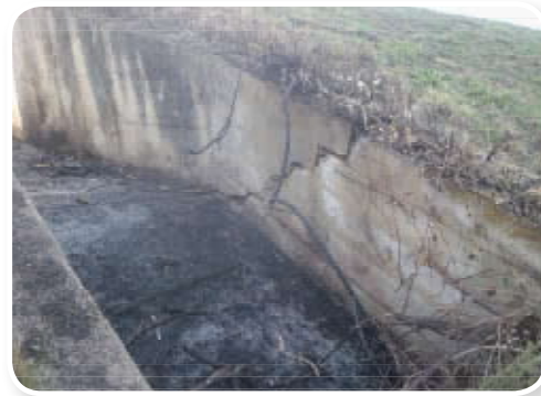
Fissures des parois verticales
