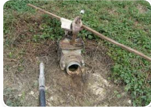
Vanne en mauvais état
