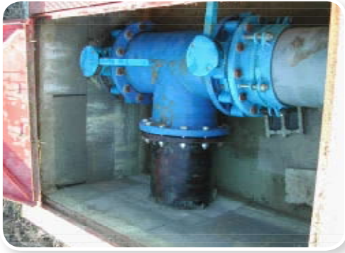
Vanne bien entretenue
